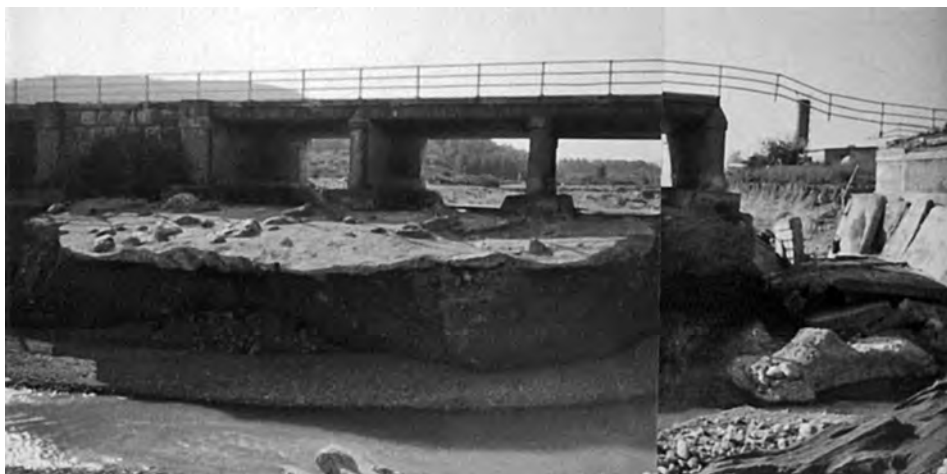
FIGURA 9. Muntatge fotogràfic del pont de la rambla de Cervera derrocat en la riuada del 2000. Imatge presa per F. Segura.
