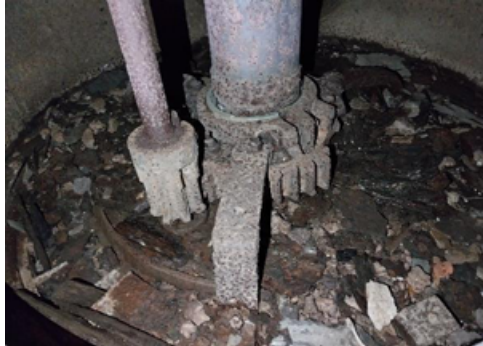
FIGURA 8. Interior de la caixa.
